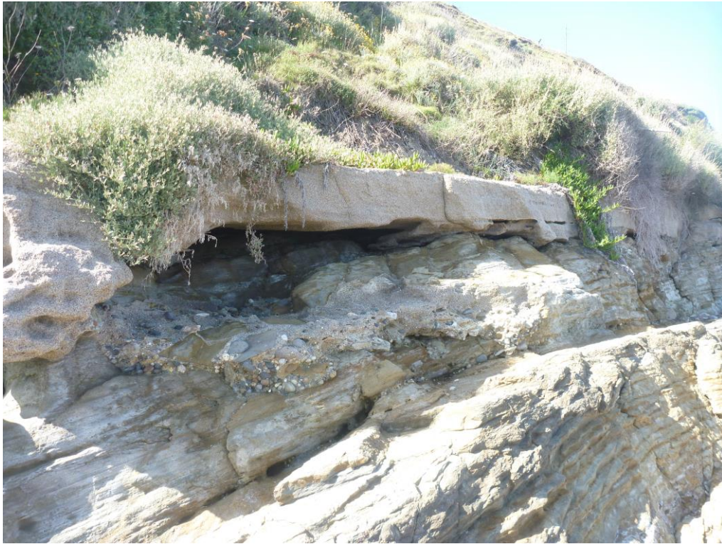
Foto 1: Sottoescavazione il corrispondenza del contatto tra il substrato litoide e la soprastante formazione sabbioso-arenacea.
