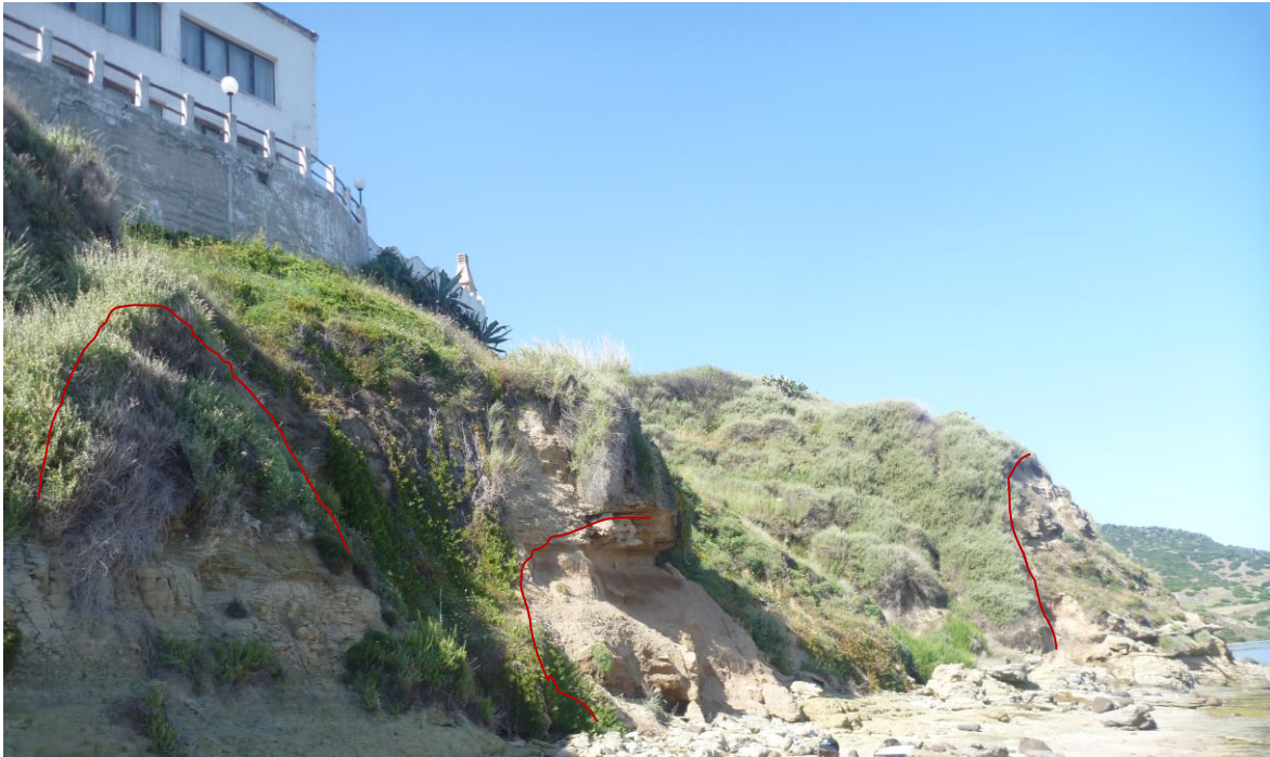
Foto 3: Smottamenti nel tratto compreso tra le sezioni A e 2.
